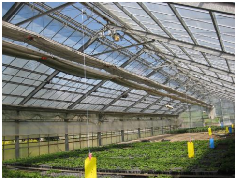
▲天窓側窓の開閉装置
