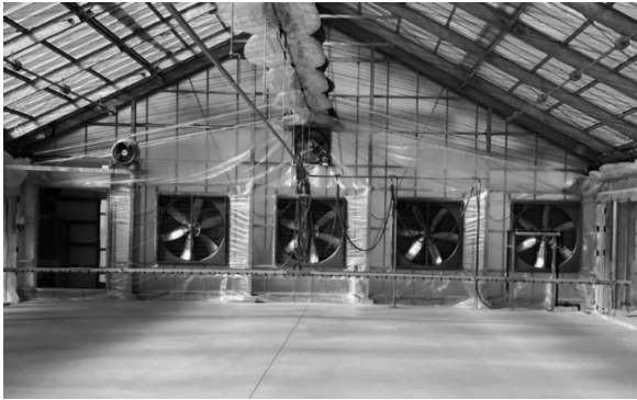
▲閉鎖型ハウス（自動カーテン、散水設備）
