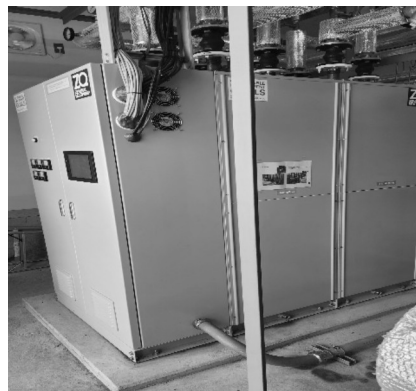
<地中熱・廃熱回収ヒートポンプ>
